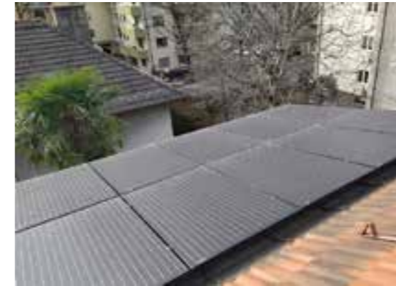
Bild 4: PV-Anlage auf Gaube mit unauffälligen Modulen in schwarz
